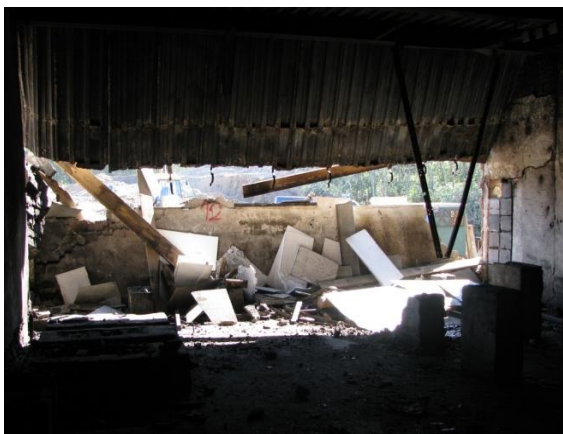
Obr. 8: Vnitřní pohled destrukce přední stěny
