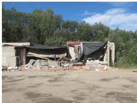
Obr. 7: Destrukce přední nosné stěny po zk. 3
