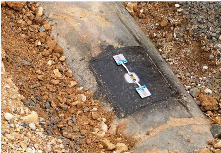
Obr. 5: Tenzometry zaznamenávající změny vnitřního napětí v chráničkách
