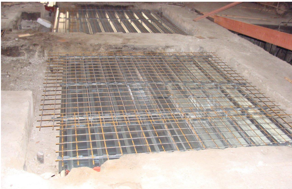
Obr. č. 12 – statické zajištění otvorů v podlaze kompresorovny
