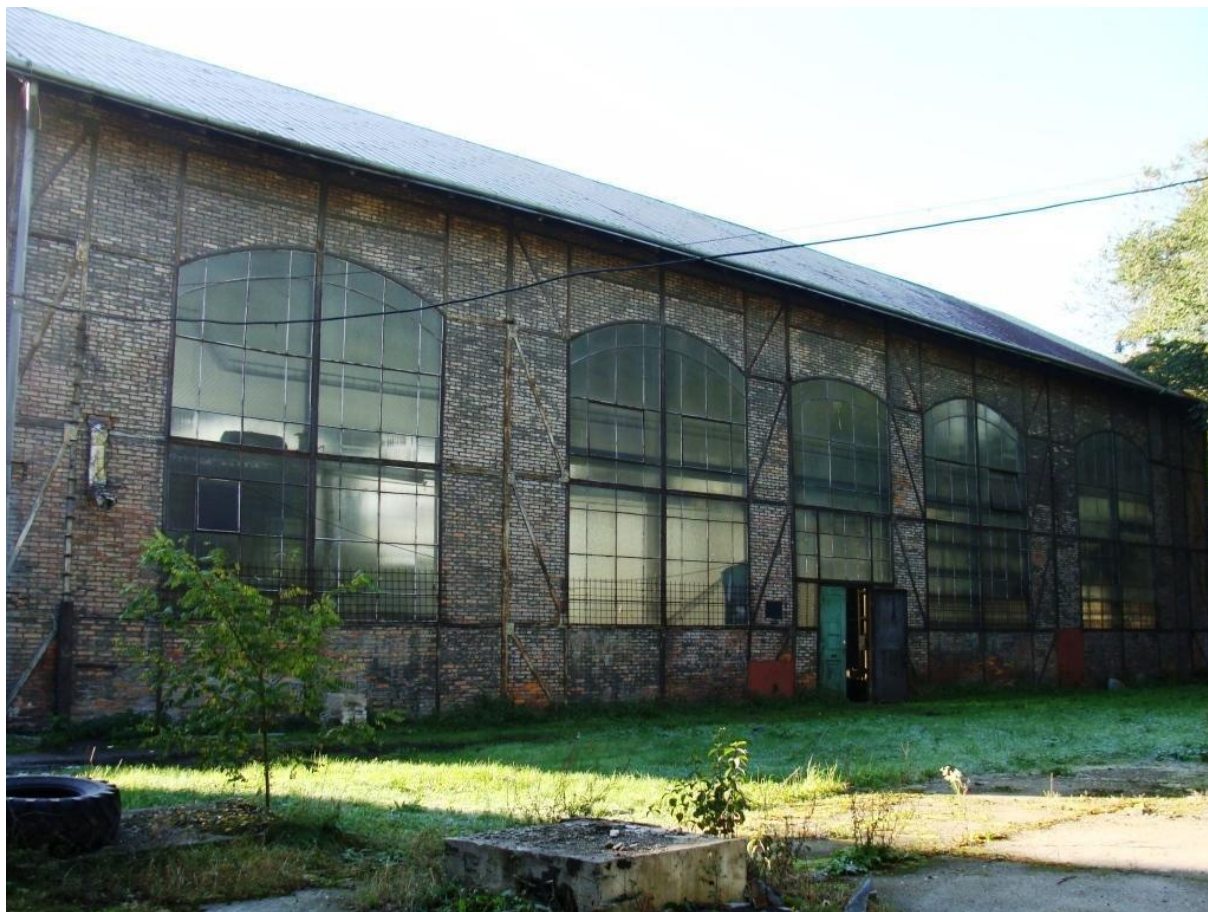
Obr. č. 4 - kotelna
