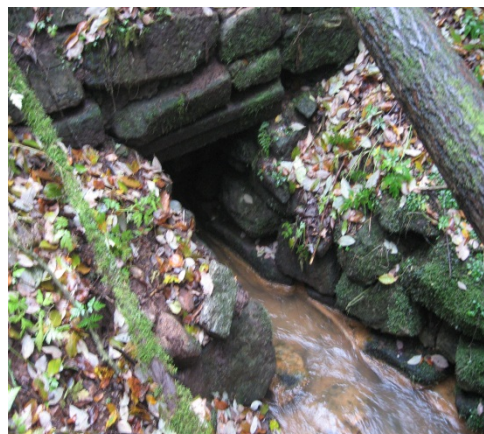
Obr. 4: Výtok důlní vody – Šlikova štola
