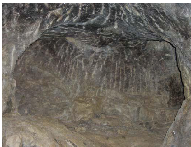
Obr.4a Vrypy do stropů komory (foto Uhlík, 1998)
