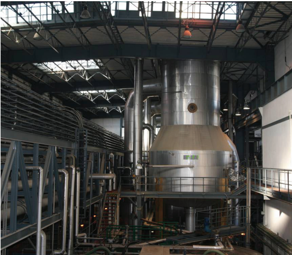
Obr. č. 4 SLKR I, stanice likvidace kyselých roztoků - odparka
