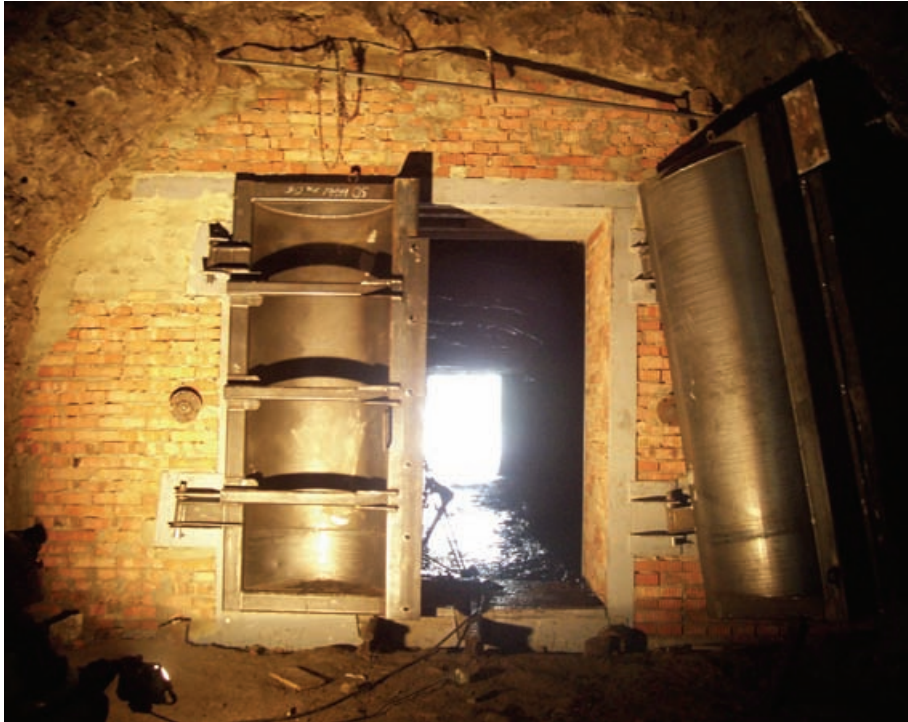
Obr. 2 Dveře HDDK-ZD-5-1, pohled proti hrázi
