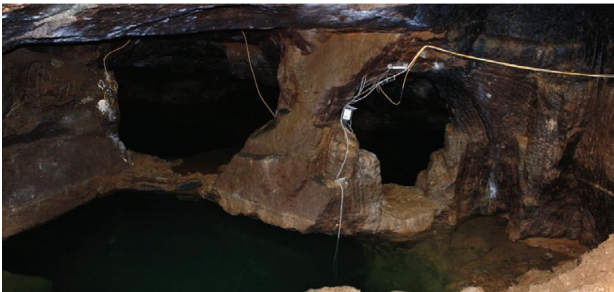
Obr. 3: Porušený klenbový pilíř
